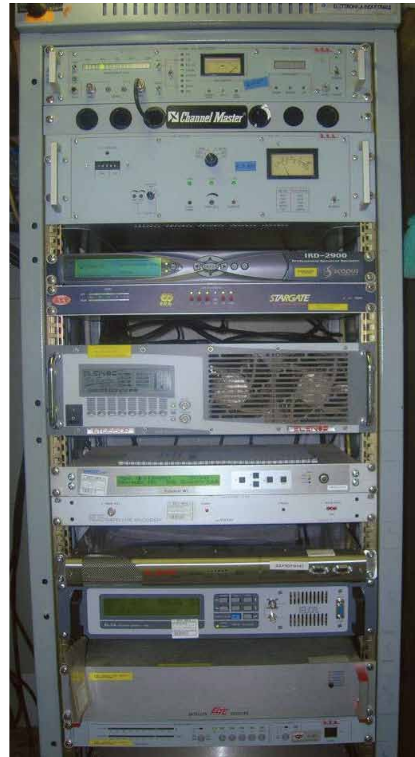
Le apparecchiature in una delle tante postazioni di montagna della STA.
